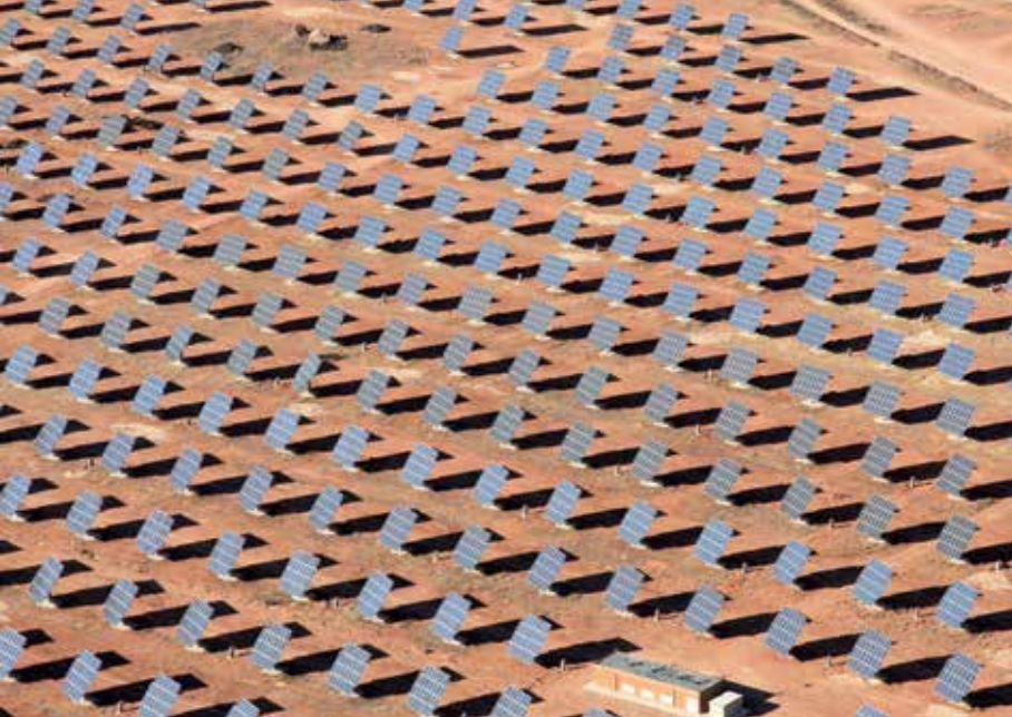
Photovoltaik-Anlage in der Gemeinde El Bonillo, Provinz Albacete, Spanien.
